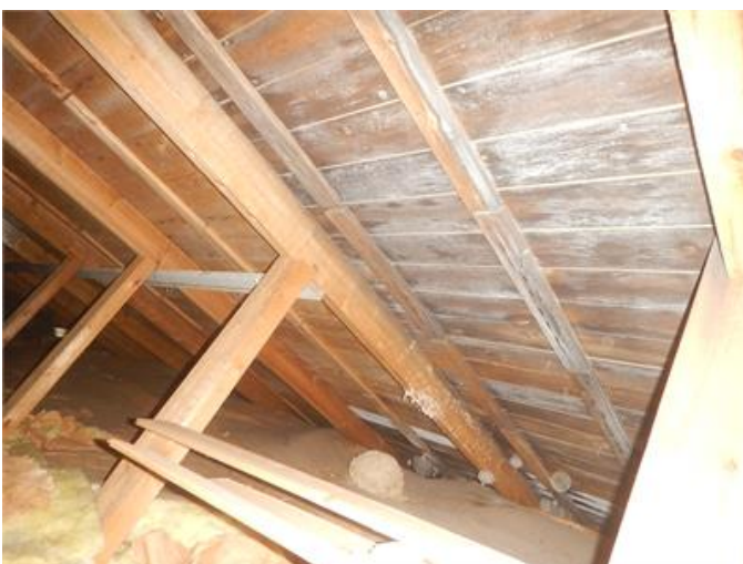
Exempel på mikrobiell påväxt på underlagstak.
