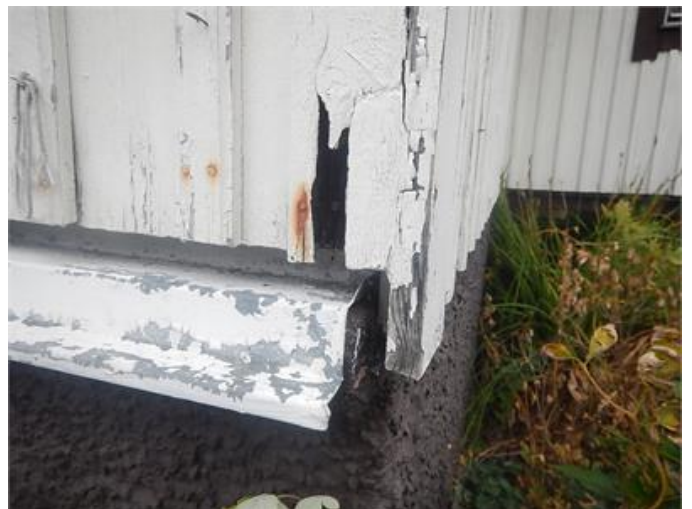
Exempel på rötskadad fasadpanel.
