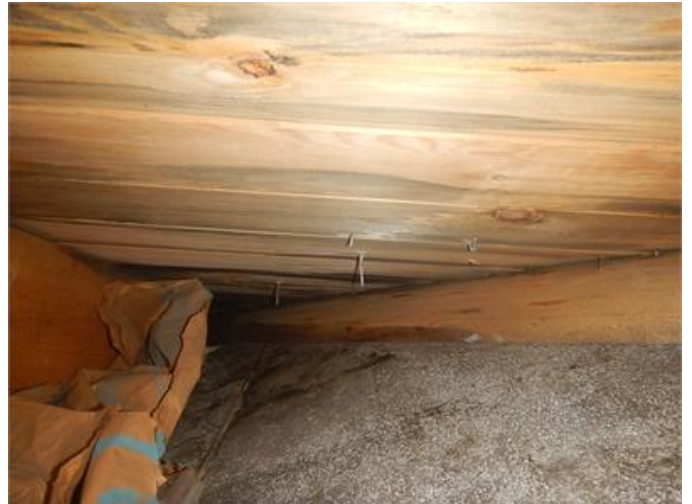
Exempel på fuktpåverkat underlagstak under ränndal.
