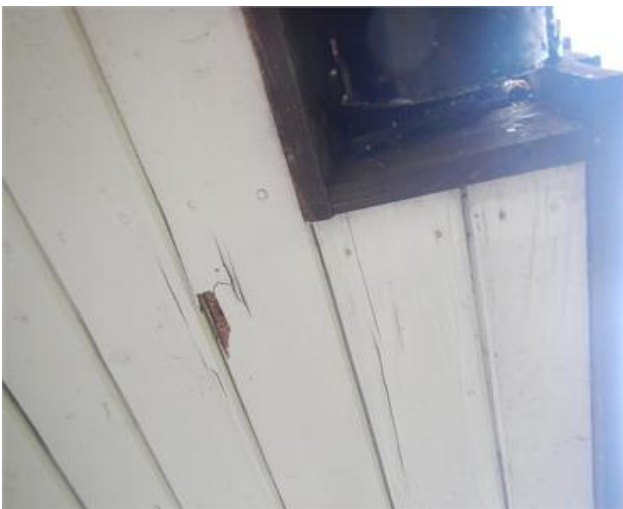
Exempel på rötskada i takfot.
