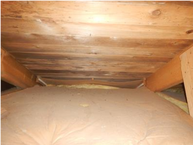
Exempel på mikrobiell påväxt på underlagstak.
