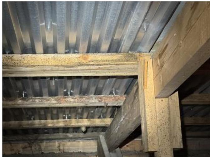
Bild visar mikrobiell påväxt på takstolar.
