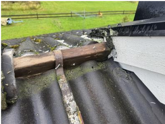
Nockregel lokalt fuktpåverkad.
