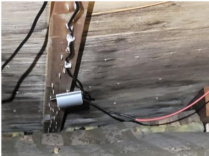
Mikrobiell påväxt på underlagstak.
