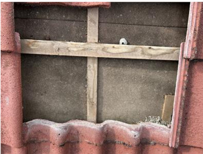
Tak: Stickkontroll under betongpannor visar ålders relaterade brister, pappan är torr och tunna strö läkt.
