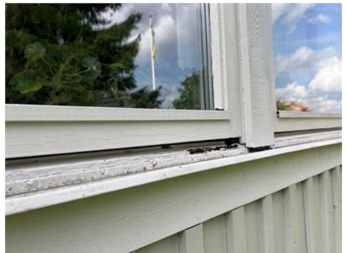
Fönster: Rötskadat fönster.
