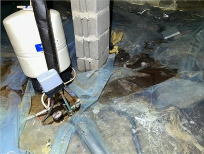
Krypgrund norr: Fritt vatten noteras på flera ställen.
