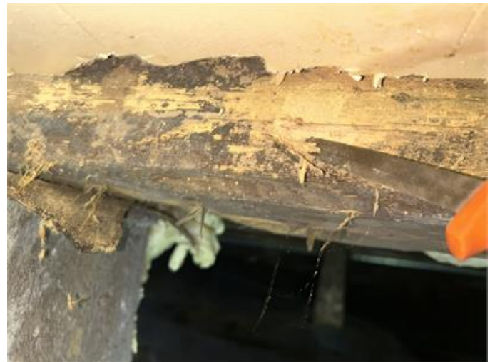
Krypgrund, mitten: Stickprovskontroll av bärlina visar ytlig rötskada.
