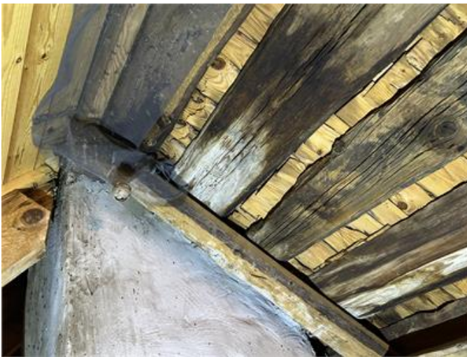
Nockvind: Fuktanvisningar och rötskador på underlagstaket vid bl.a. murstocken. Torrt vid besiktning.
