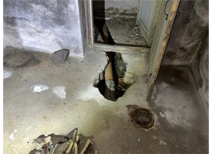
Krypgrund Norr: Källarrum: Fuktgenomslag i grundmur noteras.
