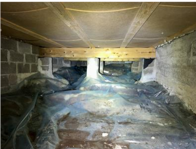
Krypgrund, söder: Översiktsbild med notering fritt stående vatten.
