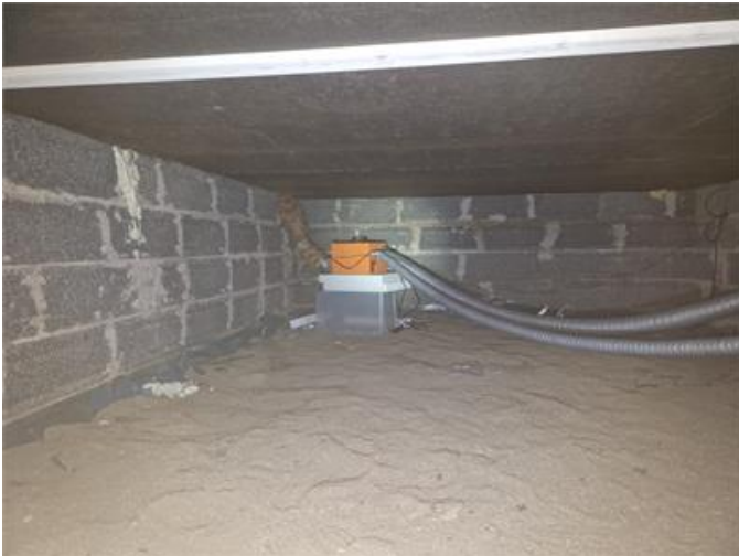
Krypgrund, översiktsbild nordöstra delen där krypgrundsavfuktaren står.
