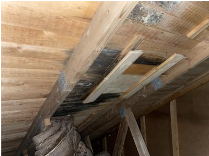
Vind med avslutade ventilationskanaler
