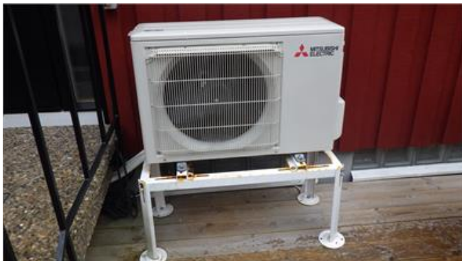
Värmepumpens utomhusdel vid fasaden
