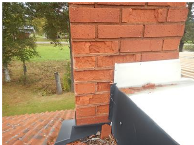
Stenar som eroderat på skorsten (södra).
