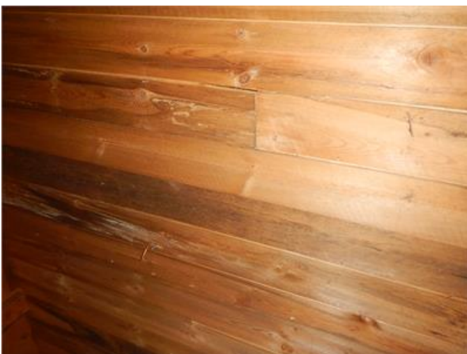
Fuktfäckor på underlagstak (vind).
