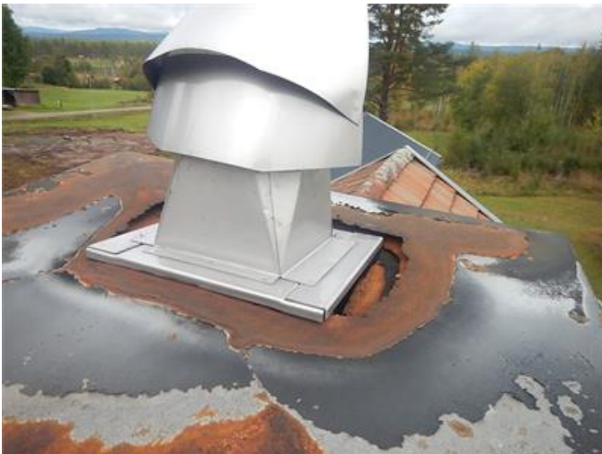
Rostpåverkat väderskydd på skorsten mot norr.
