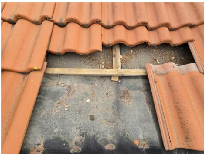
Tak: Stickprovskontroll under pannor vid takkupa.
