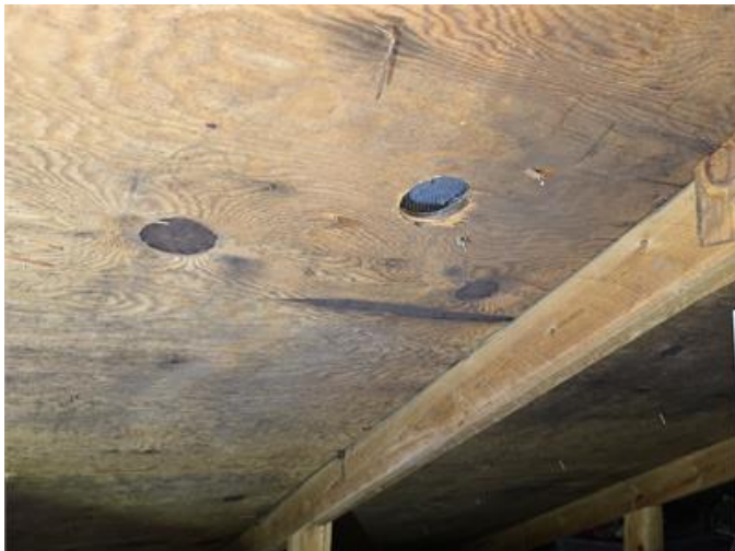
Nockvind: Mikrobiell påväxt på underlagstak.
