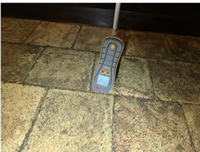
Förhöjd fuktindikation i källarens uppreglade golvkonstruktion.
