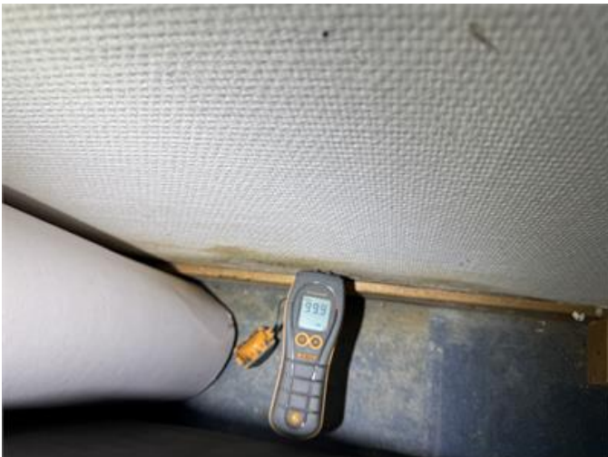
Hög fuktindikation i utreglad vägg "nedre etage".
