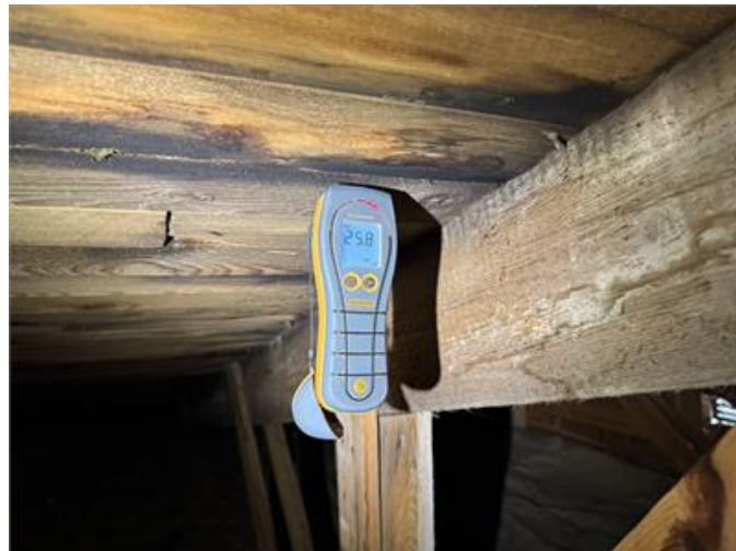
Förhöjda fuktkvotsvärden i underlagstak på vind "ovan garagetak"
