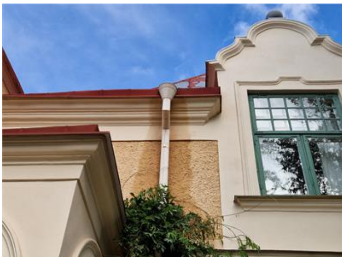
Fasad och Sockel: Fuktpåverkan i fasadputs förekommer.
