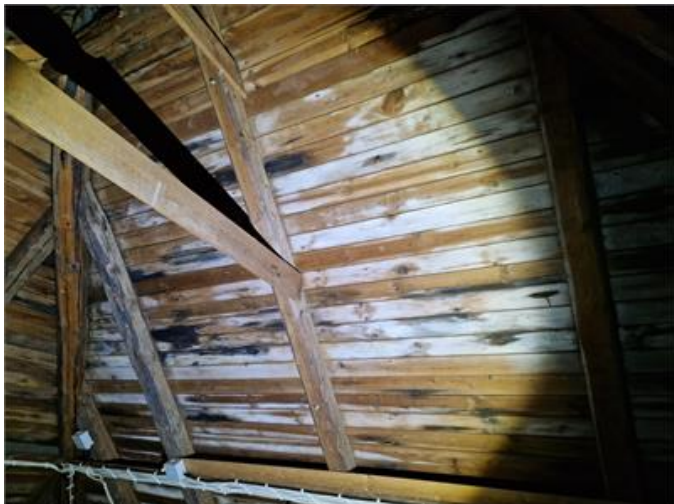
Vind: Mikrobiell påväxt/Missfärgningar förekommer på underlagstakets undersida
