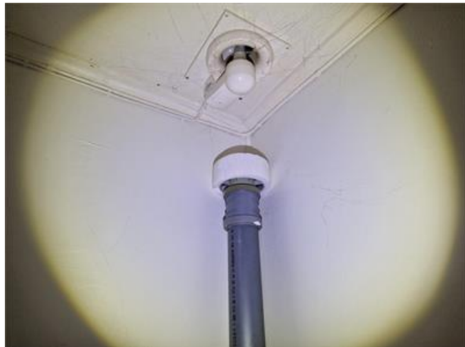
Dusch/Wc 1: Avloppsavluftning avslutas i utrymmet
