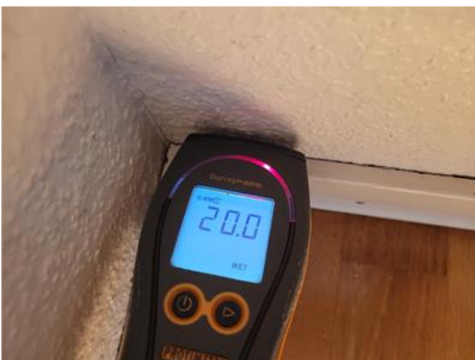
Förhöjd fuktkvot mättes upp i golv/vägg vinkeln
