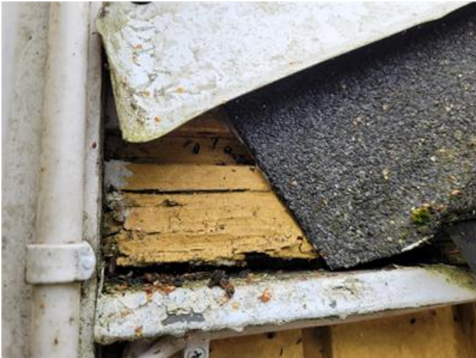
Fasadpanelen har rötskador
