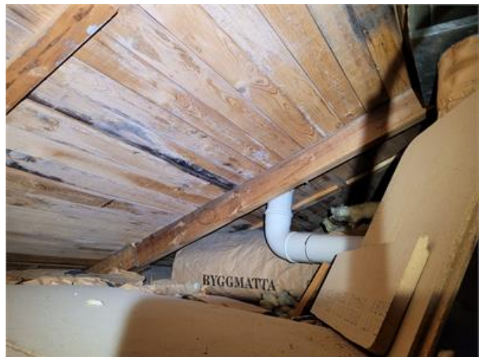
Mikrobiell påväxt samt fuktfläckar på underlagstak
