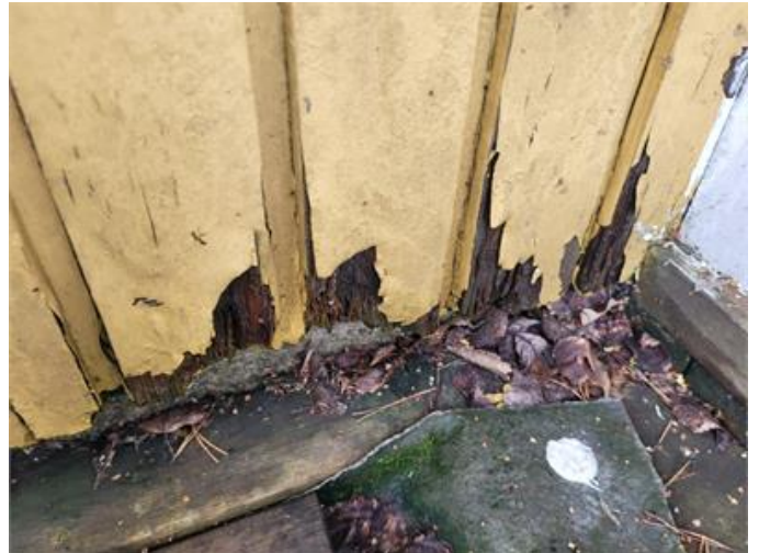
Fasadpanelen har rötskador
