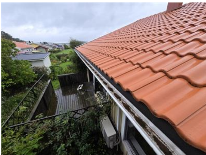
Stuprör/rännor: Stående vatten, justeringsbehov. Takpapp används som fotplåt.
