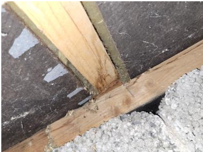
Fuktfläckar på golvbjälklag
