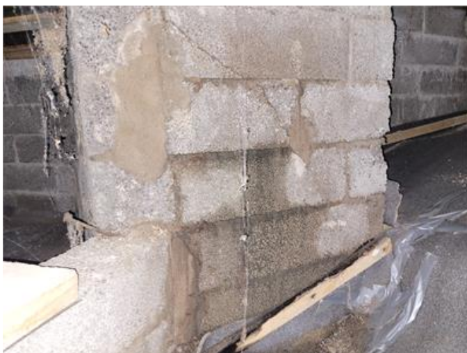
Spricka i grundmur
