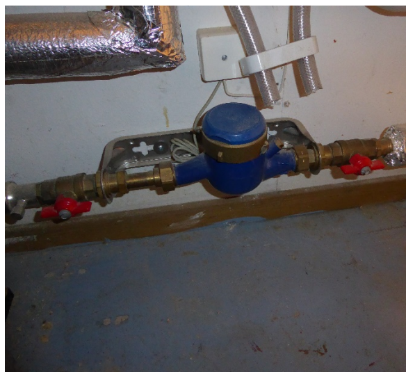
Avstängningskranar i atriumhus är likadana som de under radhusen
