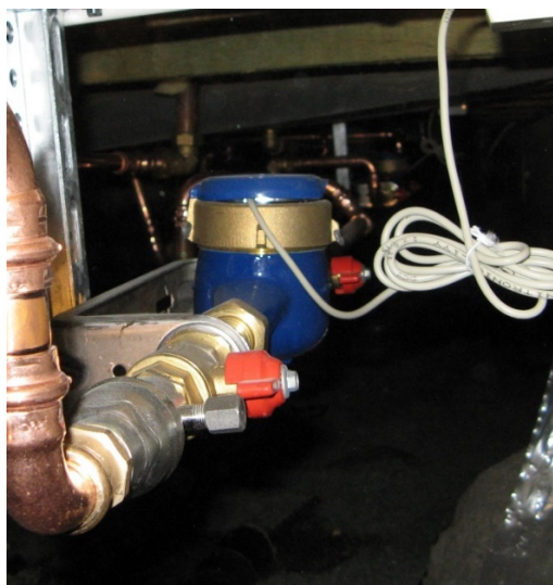
Avstängningskran radhus. De röda kranarna vid vattenmätaren stänger allt vatten till fastigheten.
