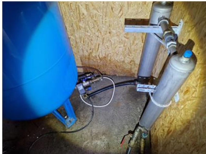
Pumprum: Fuktuppsug noterades i innervägg.
