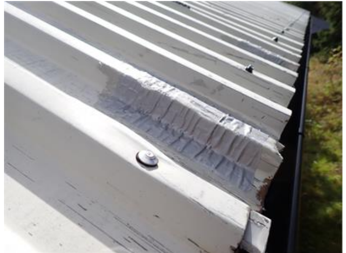
Skador (tätade) i takplåt.
