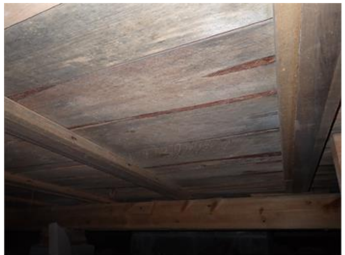
Mikrobiell påväxt på blindbotten krypgrund.
