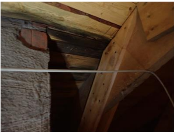
Mikrobiell påväxt på underlagstak vind.
