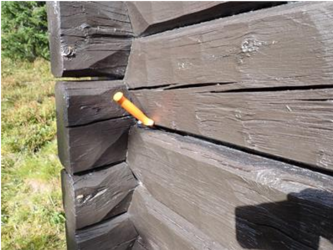
Rötskadad timmerstock fasad.
