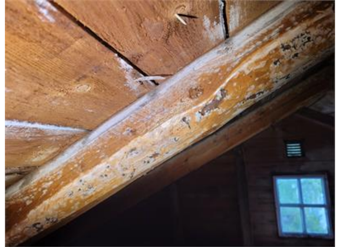
Mikrobiell påväxt förekommer på underlagstak.
