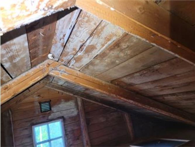
Mikrobiell påväxt förekommer på underlagstak.
