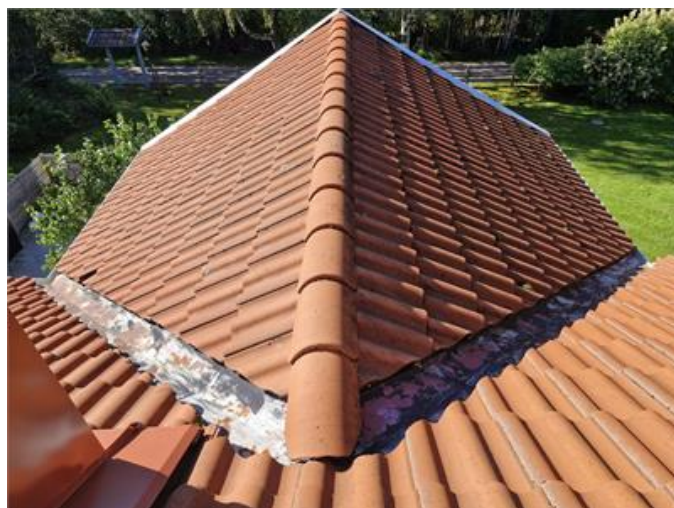
Tak, mindre mosspåväxt samt rostangripna rännalsplåtar.
