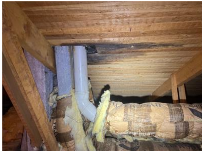
Exempel på fuktfläckar i underlagstaket i vindsutrymmet.
