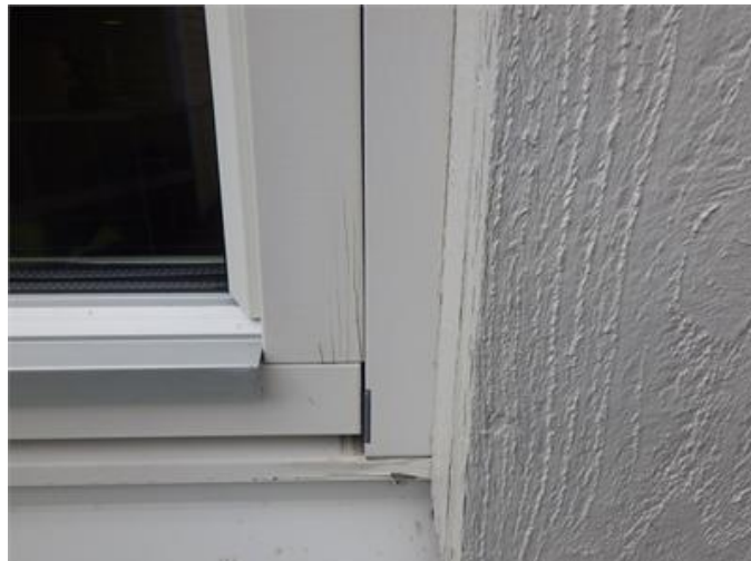
Visst underhållsbehov av fönster.
