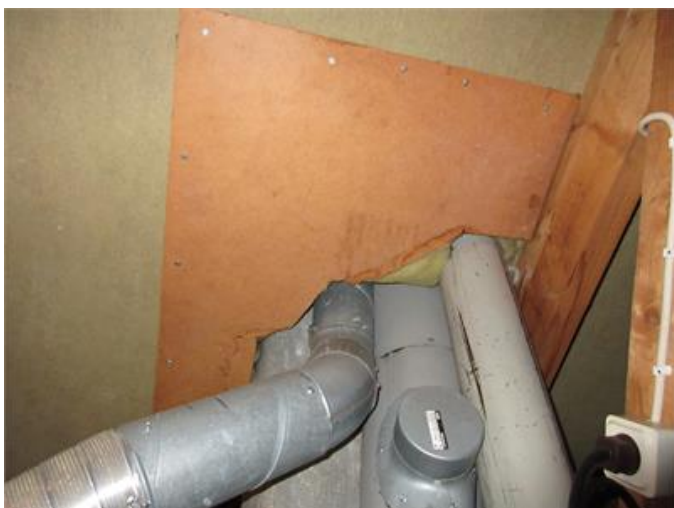
Missfärgningar i tak inockvind
