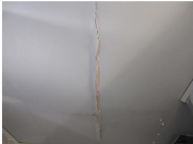
Läckage i tak i teknikrum
