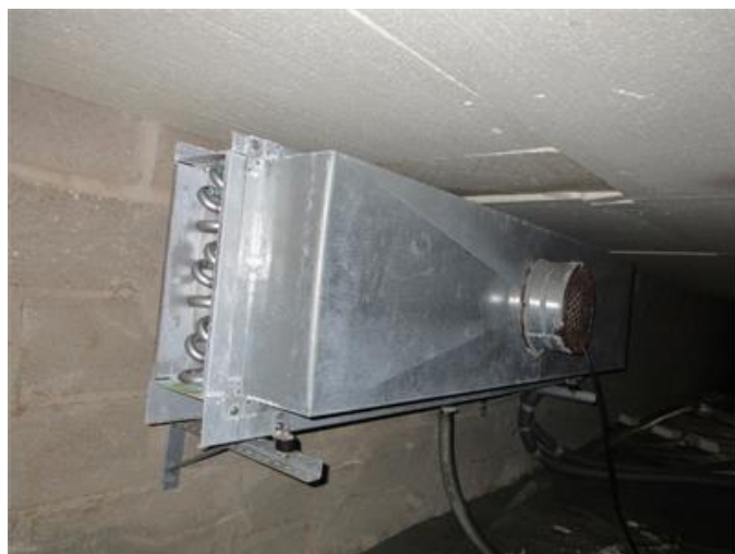
En av två kylfläktar i krypgrund
