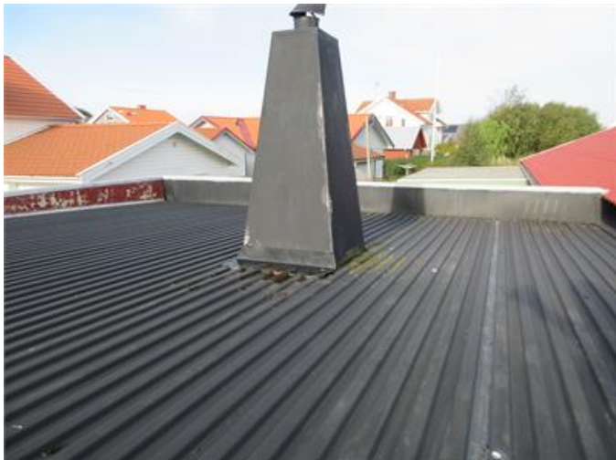
Takplåt med brister på lägenhet
