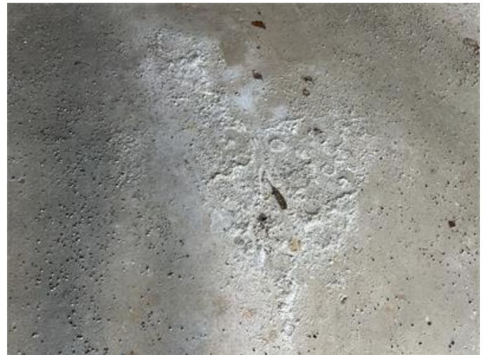
Garage: Utfällningar i betongplattan noteras.
