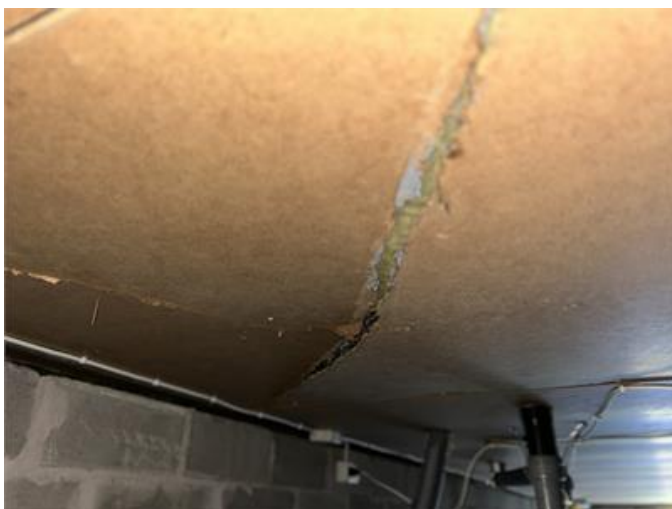
Krypgrund: Otätheter noteras i trossbottenskivor.
