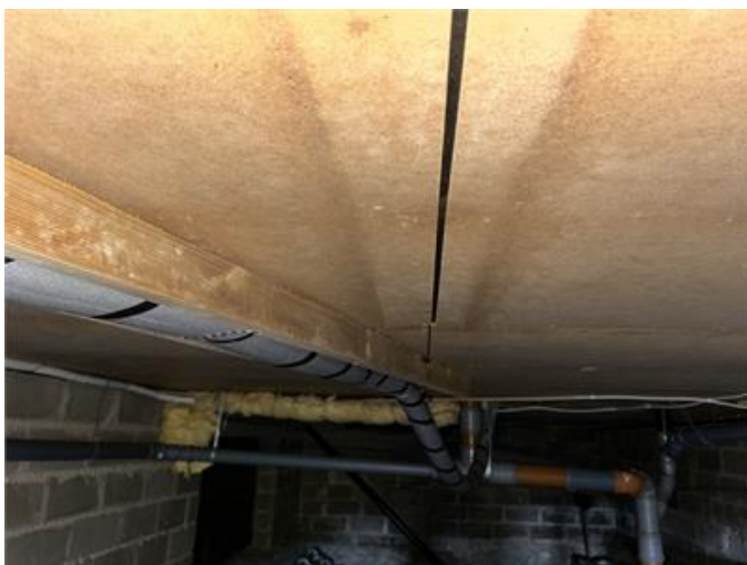
Krypgrund: Mindre mikrobiell påväxt på trossbottenskivor.
