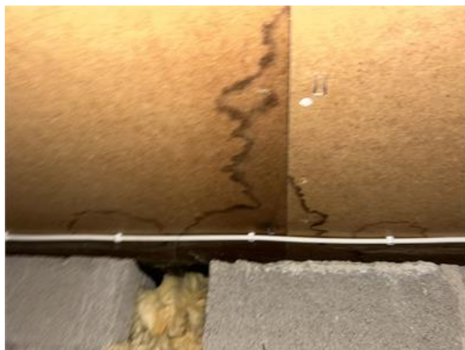
Krypgrund: Fuktanvisning på trossbotten skiva i bl.a. sydvästra hörnet.
