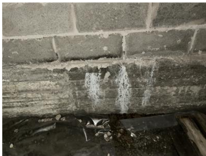
Krypgrund: Salt/kalk utfällning noteras i nederkant grundmur.
