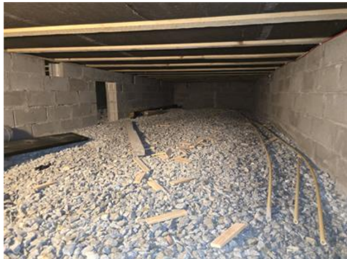
Krypgrund: Översiktsbild vid inträde till utrymme, mindre del byggspill förekommer.
