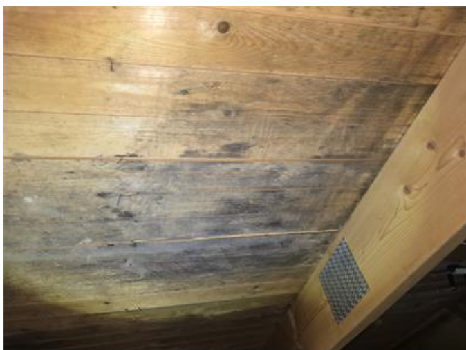
Nockvind: Mörk mikrobiell påväxt på underlagstak mot väst.
