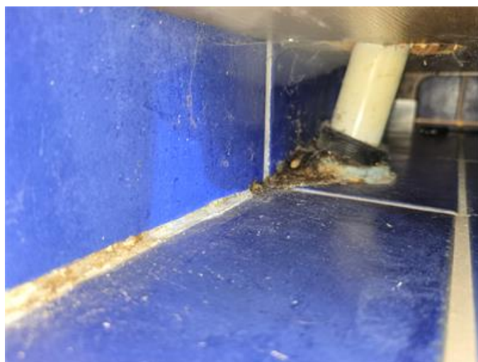
Bad/Wc: Exempelbild på avlopp nära vägg.
