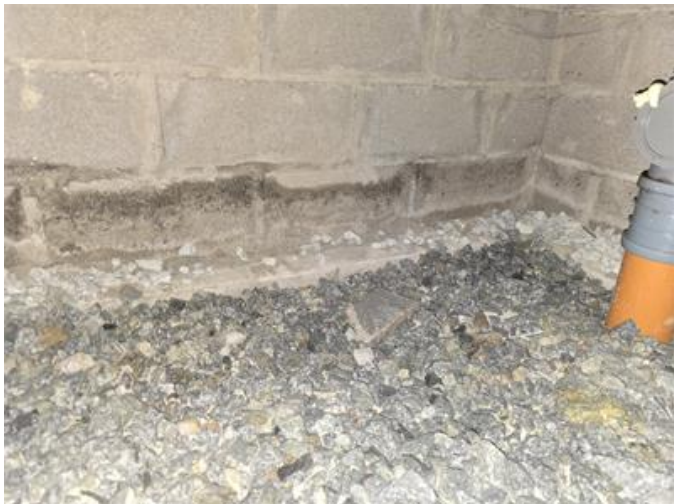
Krypgrund: Fuktgenomslag i nederkant på grundmuren mot väst.
