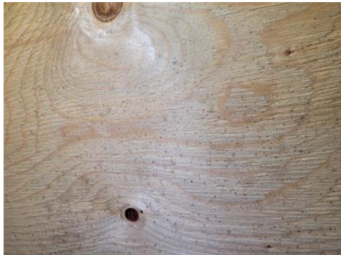
Mikrobiell påväxt på underlagstak.
