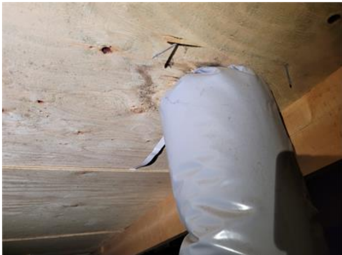
Fuktfläck på underlagstak.
