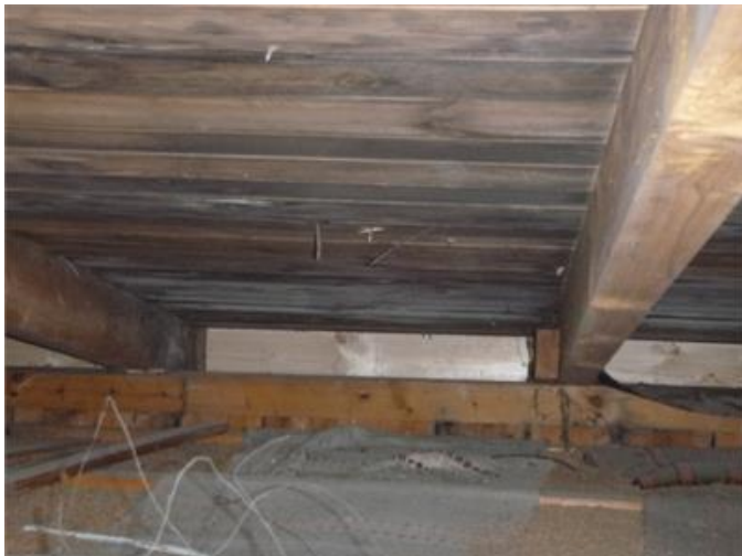
Mikrobiell påväxt på insida yttertak
