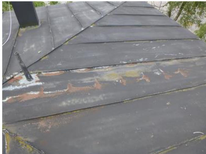
Äldre taktäckning med ytrost
