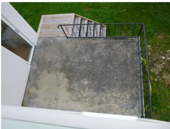
Altangolvet utgör tak för underliggande konstruktion, skärmtak eller tätskikt saknas
