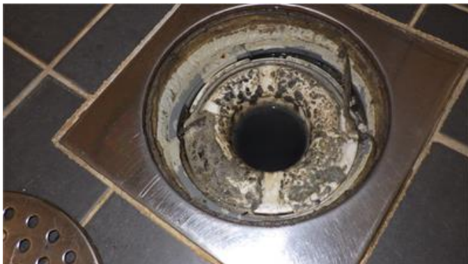
Exempel på golvbrunn där brunnsmanschetten sticker fram brunnen
