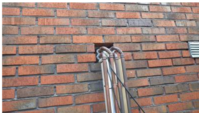
Otät rör genomföring i fasaden
