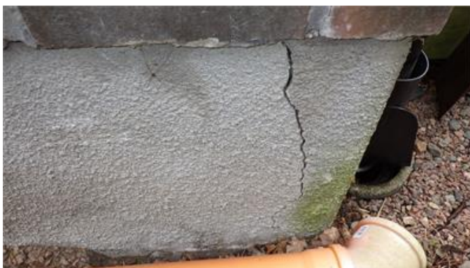
Spricka i sockeln
