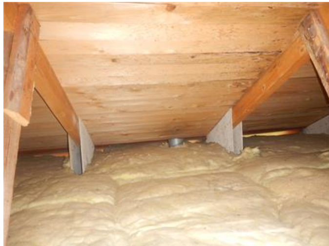
Ventilationstrumma som avslutar på garagevind samt mikrobiell påväxt på underlagstak.
