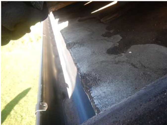
Torrsprucken takpapp på huset.
