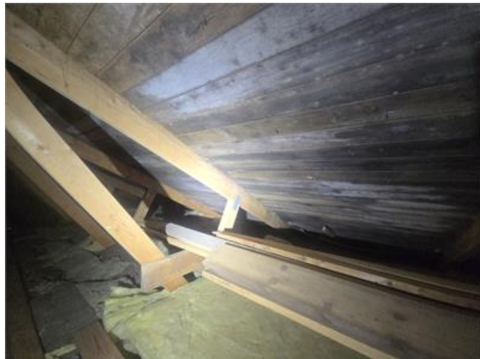
Översiktsbild, vind med mikrobiell påväxt på underlagstaket.
