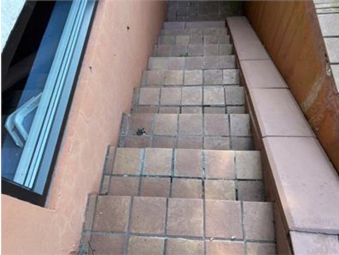
Källartrappa utsida: Spruckna och lösa klinkerplattor noteras och Krackeleringar i sockel.
