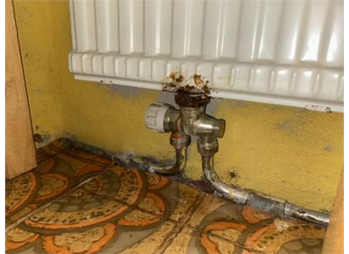
Källare: Rostangripen koppling vid radiator i matkällaren.
