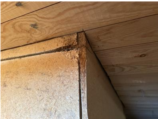
Nockvind: Fuktanvisning på bl.a. trumma för skorsten. Torr vid besiktning.
