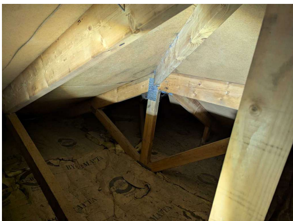
Bild 7: Utvändigt, Vind, Vissa fuktfläckar på takskivor
