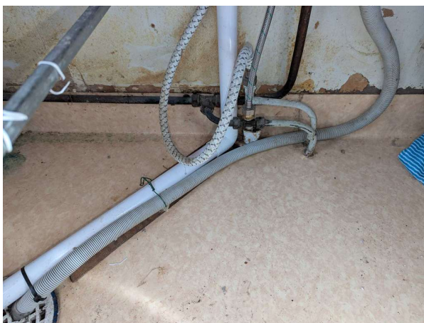
Bild 14: Invändigt, Entréplan, Tvätt, Utrymmet är ålderstiget Rör genomföringar i golv
