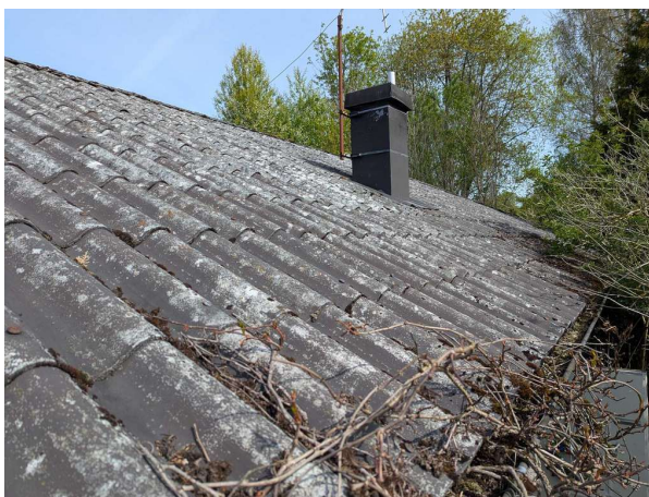
Bild 8: Utvändigt, Yttertak, Taket är ålderstiget
