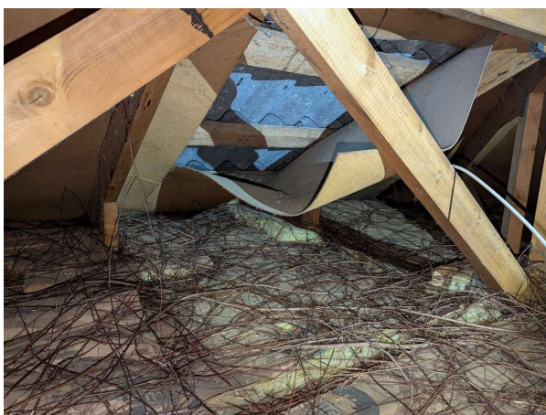
Bild 6: Utvändigt, Vind, Klätterväxt från utsidan i stora delar av utrymmet. Takskena har lossnat
