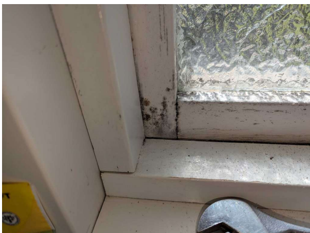
Bild 11: Invändigt, Entréplan, Dusch/toalett, Fönster i duschzon, glastruta sprucken samt mögelfläckar på fönsterbåge
