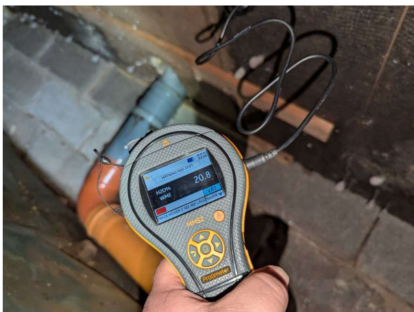
Bild 16: Invändigt, Krypgrund 1, Fuktmätning i åtkomliga delar bjälklag, fuktkvot över 20% Fuktkvot (FK) indikerar i procent hur mycket vatten finns i materialet i relatio...
