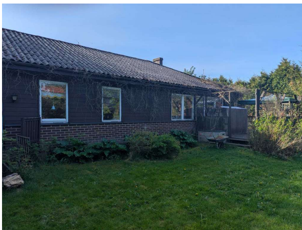
Bild 4: Utvändigt, Fasad, Den ymniga växtligheten har trängt in i stora delar av tak och bjälklag.
