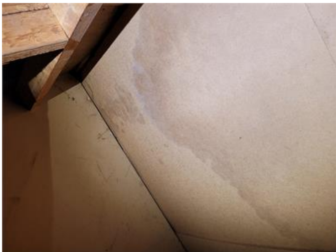
Fuktfläck på underlagstak
