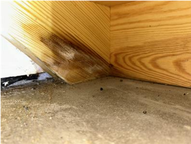
Källare trappförråd: Fukktanvisning på trappvangel.
