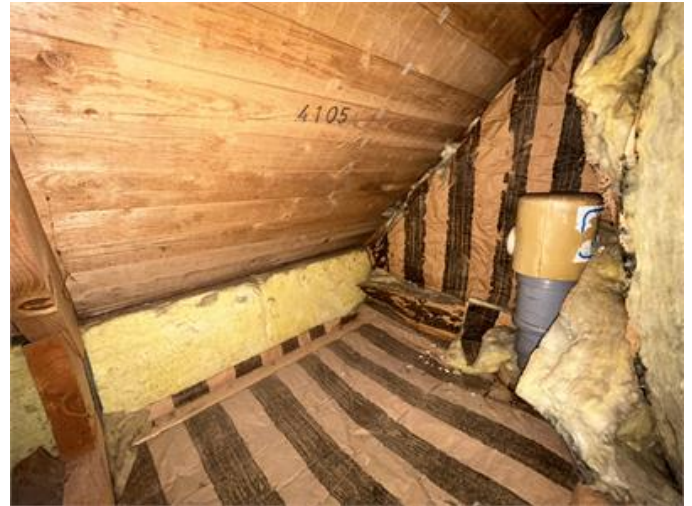
Sidovind: Översiktsbild med Kolfilter till avloppsluftare.
