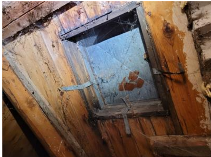
Fuktfläckar på underlagstak
