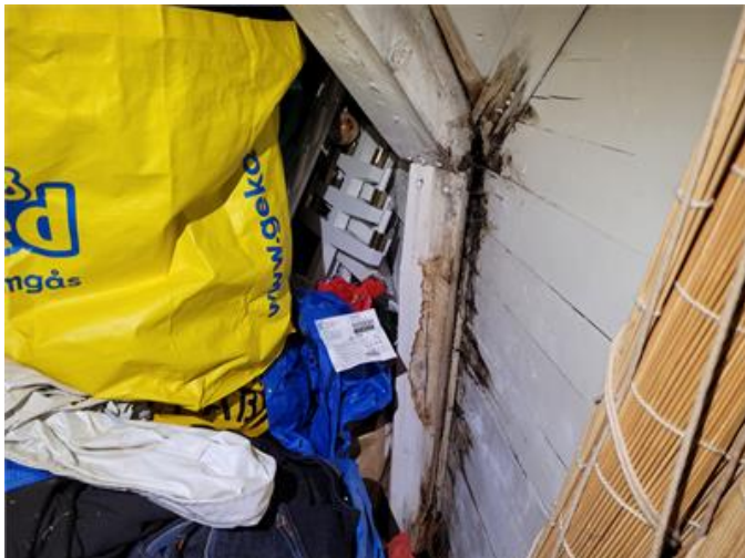
Rötskador på kattvinden förekommer
