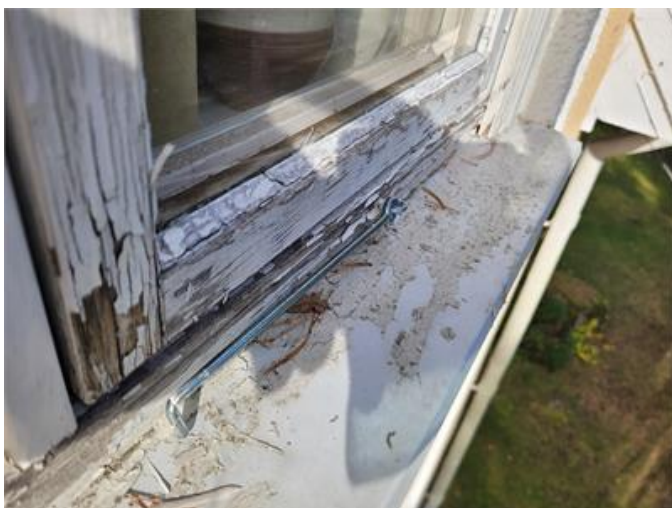
Fönster med underhållsbehov.
