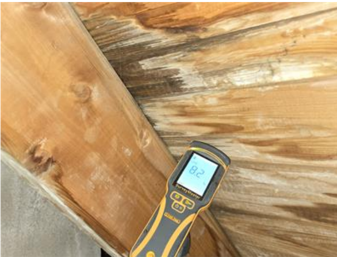
Nockvind: Fuktfläckar/missfärgningar runt murstock, torrt vid besiktning.
