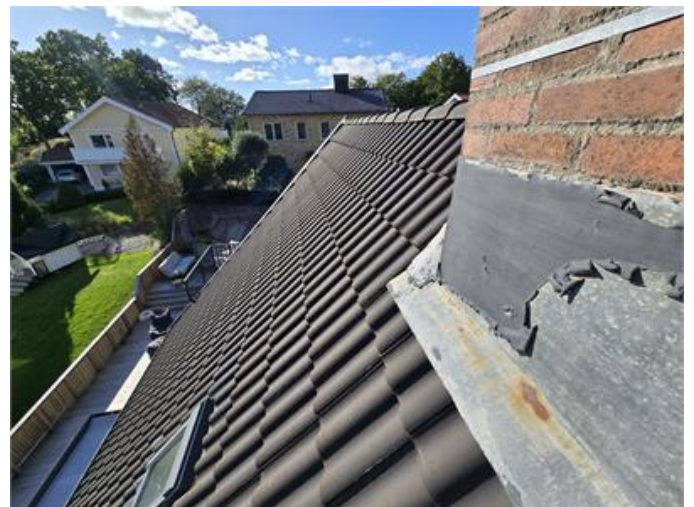
Tak: Översiktsbild, färgsläpp samt mindre otätheter noteras vid murstock.
