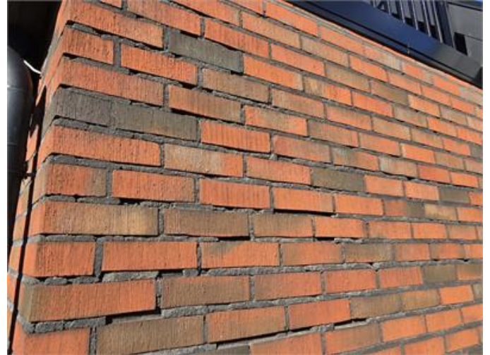
Fasad Tegel: Yttre delen av fogen på tegelfasaden har släppt lokalt.
