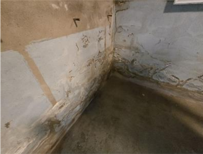
Källare: Exempelbild på fuktutslag i källare.
