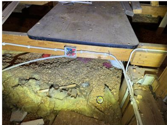
Kopplingsdosa i vindsutrymme saknar lock.
