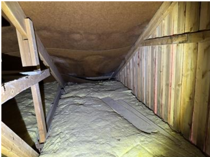
Lokalt fuktskadad masonit i vindsutrymme.
