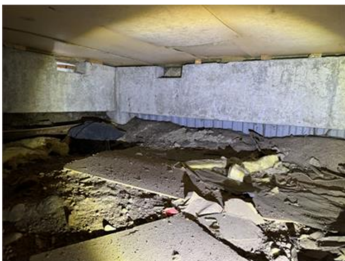
Byggspill och trärester på marken i krypgrunden.
