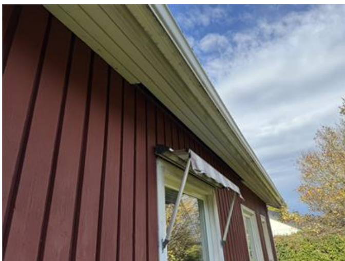
En bräda saknas i underspikning.
