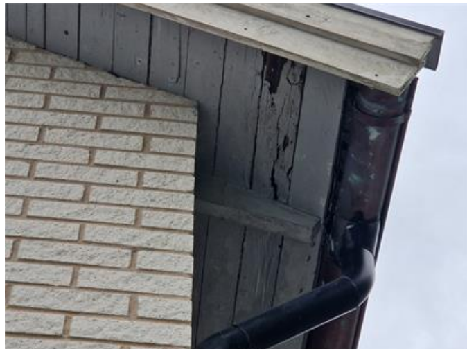
Tak: Rötskada noterades i takfot.
