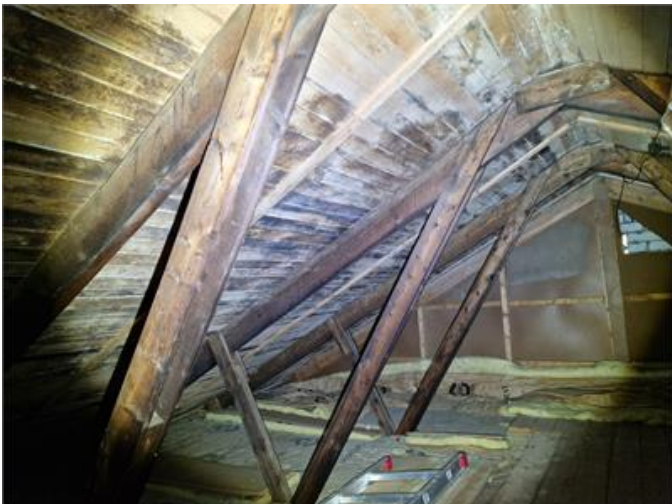
Vind: Missfärgningar förekommer i underlagstak på vind.
