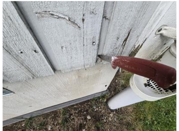
Fasad: Underhållsbehov, begynnande rötskador.
