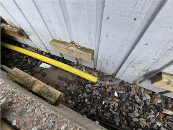
Mark: Vid entresidan och gavel finns betonggjutning i nära anslutning (5-10cm) till grundmuren.
