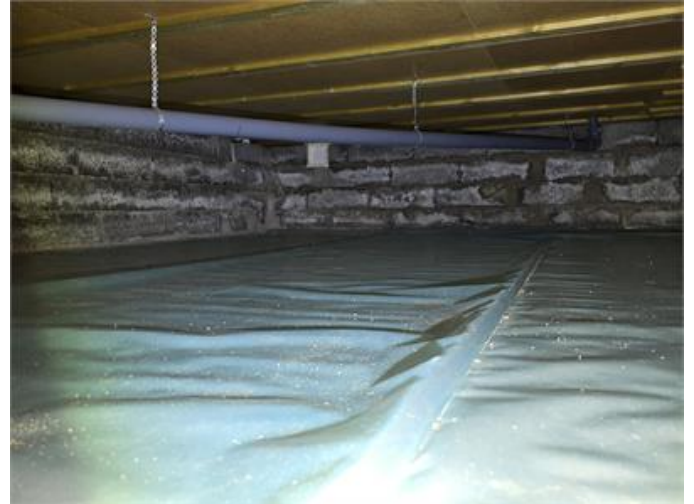
Krypgrund: Fuktgenomslag i grundmuren entresidan och gavel.
