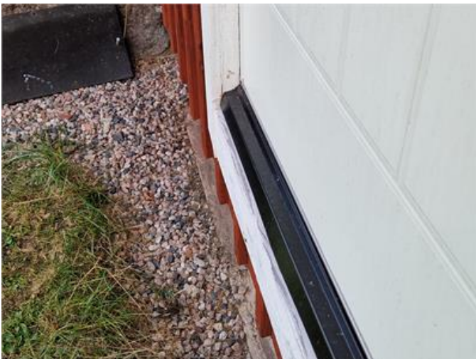
Fönster och Dörrar: Tröskelbleck saknar överhäng mot fasad
