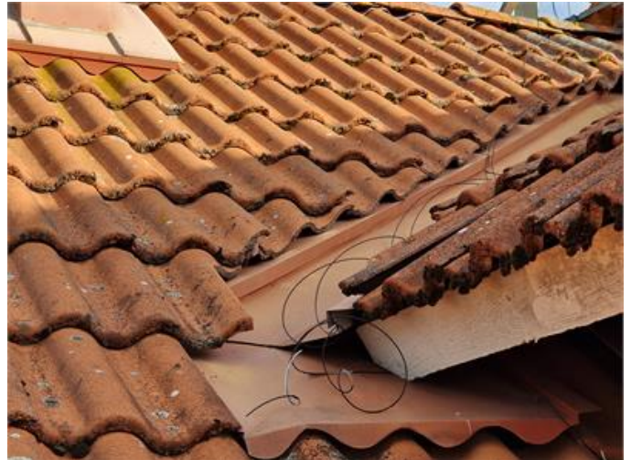
Tak: Takpannor täcker delvis dåligt över rännalsplåtar.
