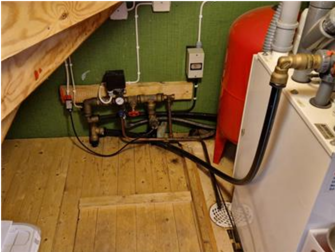
Trappfråd: Utrymme för div vatteninstallationer saknar delvis fuktskydd/vattenavrinning.
