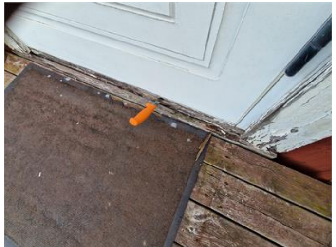
Fönster och Dörrar: Tröskelbleck saknas under altandörr och rötskador förekommer.
