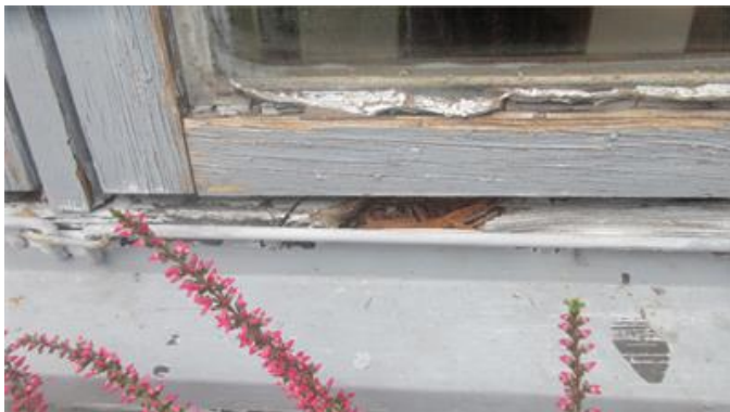
Exempel på rötskadat och otätt fönster.
