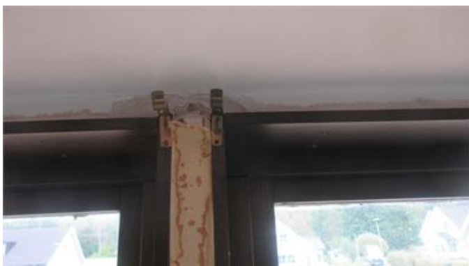
Exempel på fuktfläckar/missfärgningar i burspråket.
