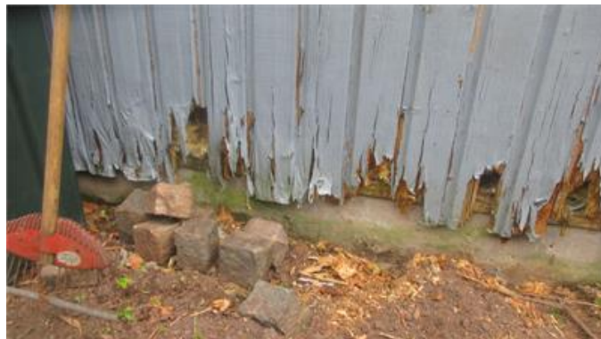
Exempel på rötskadad panel.
