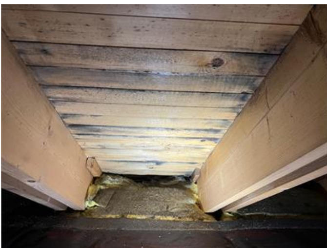
Exempel på mikrobiell påväxt i underlagstaket i vindsutrymmet.
