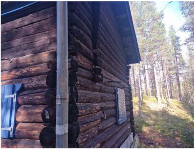
Storstuga, timmerväggar lutar kraftigt.
