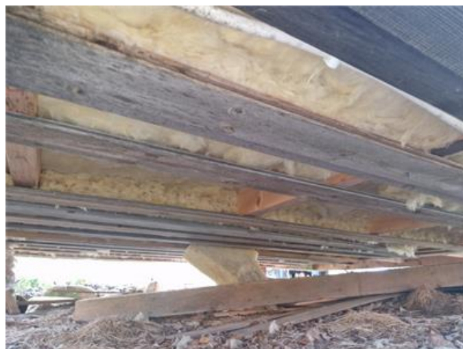
Trossbotten saknas på bastubyggnad.
