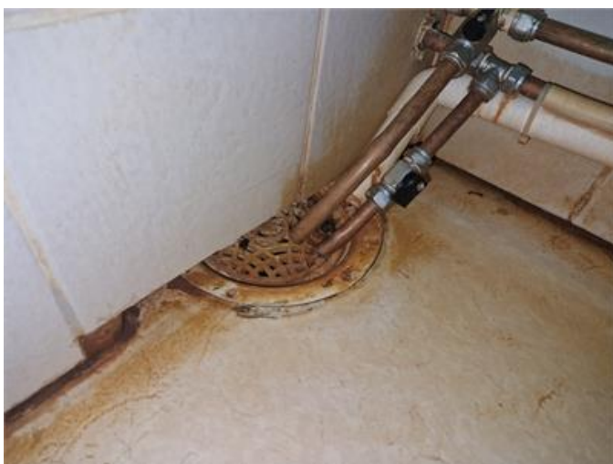
Golvbrunn är felaktigt monterad.
