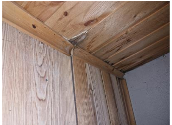
Fuktfläckar förekommer invändigt.
