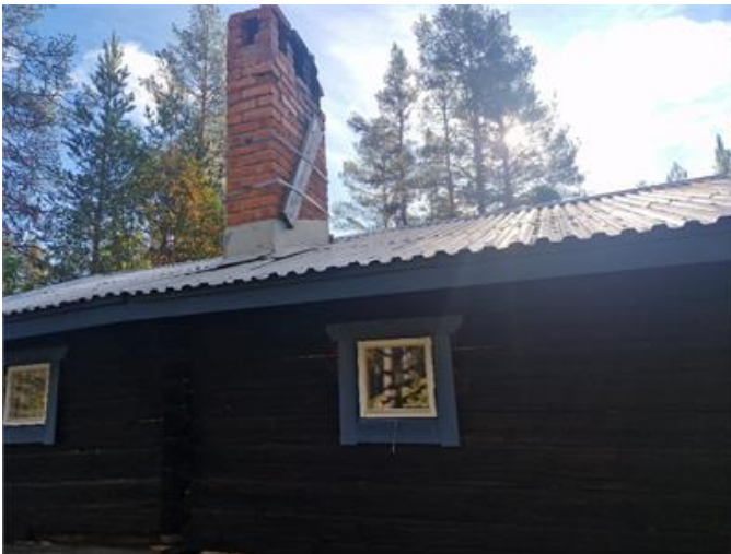
Tak av äldre snitt infästningar kryper och lösa stenar noteras på murstock.
