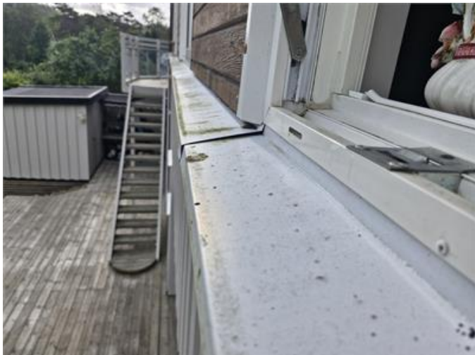
Glipor vid skarvade fönsterbleck. Trappa utan räcke.
