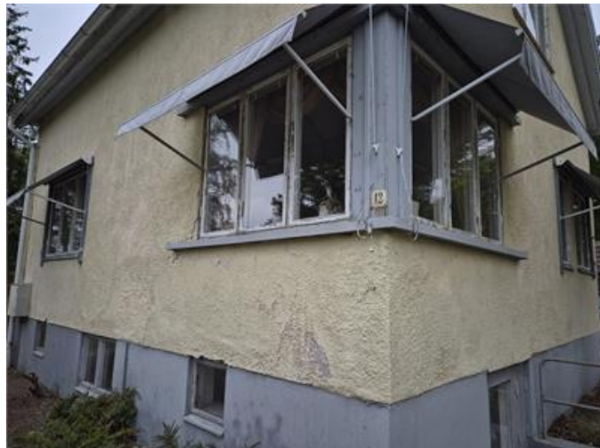
Putsskador/släpp förekommer i fasad.
