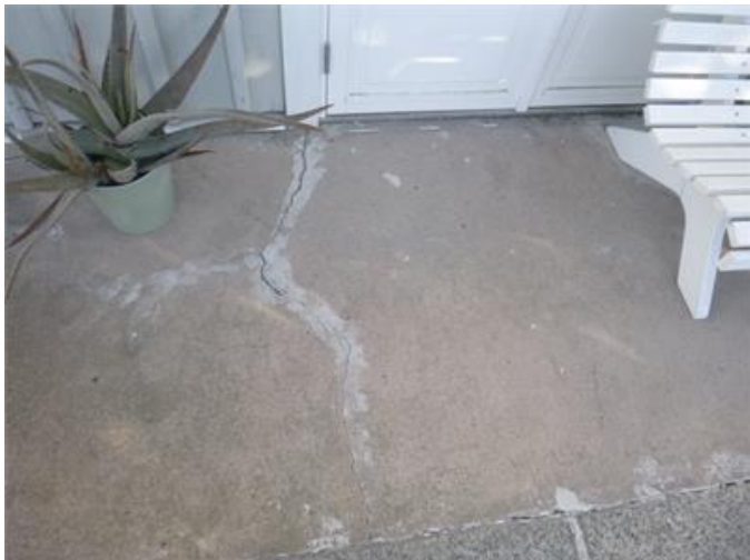
Bilden visar sprickor i terrassen.
