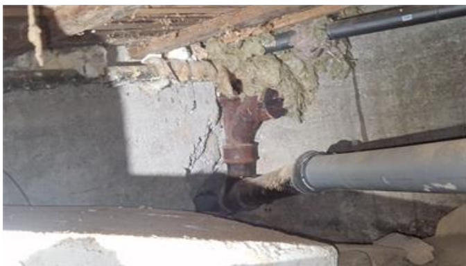
Bilden visar äldre gjutjärnsrör i grunden
