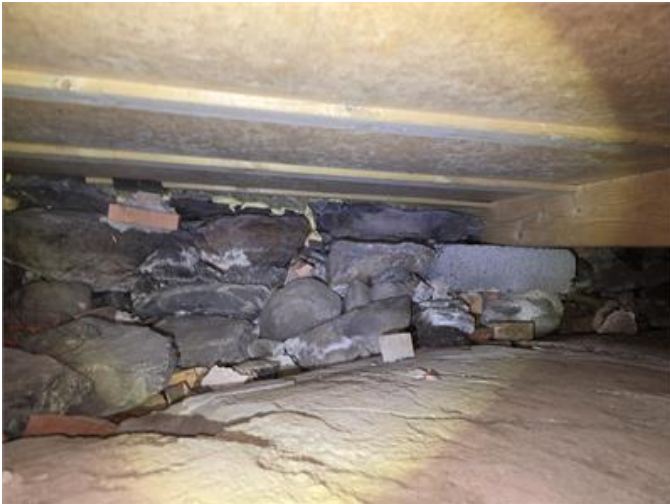
Krypgrund: Översiktsbild mot väst, mikrobiell påväxt på blindbottenskivor.
