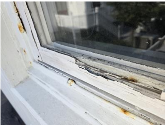
Fönster: Exempelbild på fönster med underhållsbehov.
