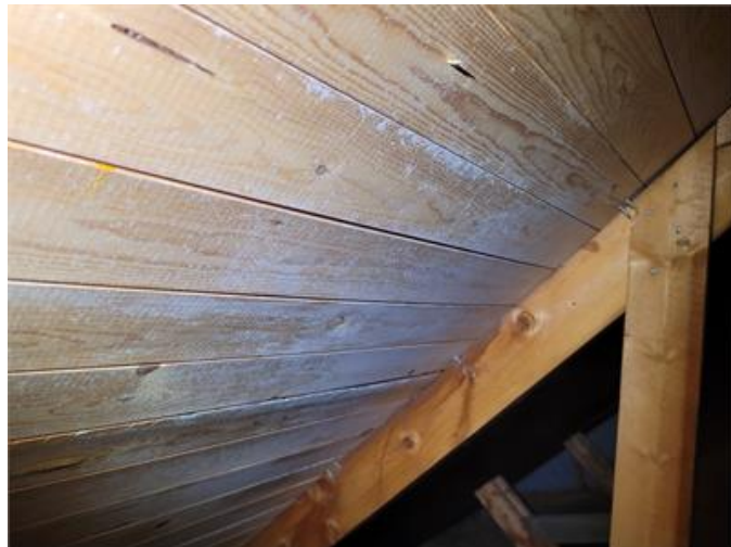
Mikrobiell påväxt på underlagstak
