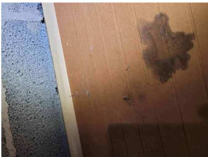
Fuktfläck på blindbotten.
