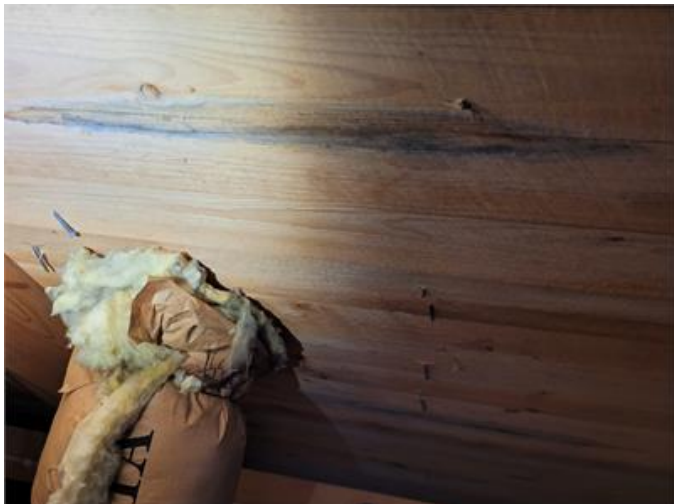
Fuktfläck på underlagstak
