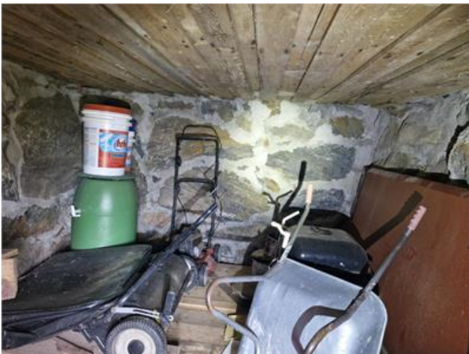
Grovkällare med fuktig miljö och förhöjda fuktvärden i regelverket innertak.
