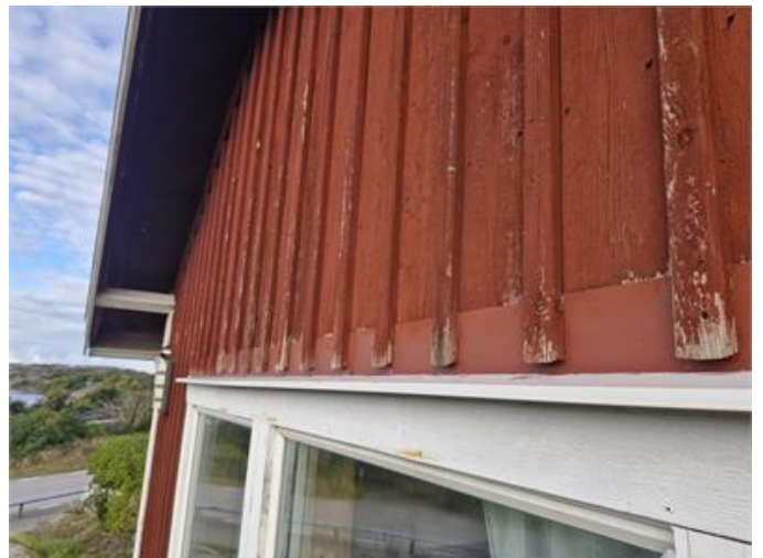
Fasad, utanpåliggande överbleck, torrsprickor och färgsläpp i panelen,
