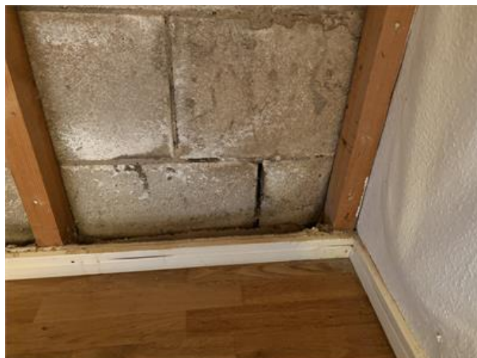
Vägg och golvkonstruktion med fuktskador i gillestuga.
