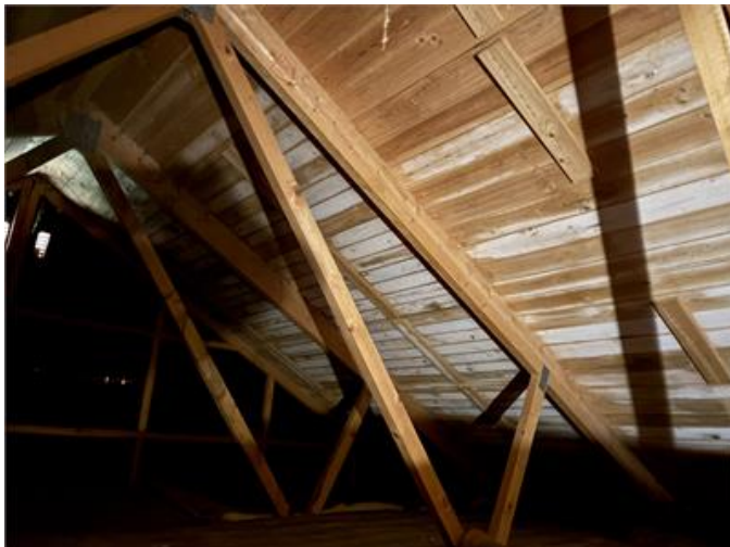
Mikrobiell tillväxt/missfärgning vindsutrymme. Ingen förhöjd fukt uppmättes i takkonstruktionen vid besiktningen.
