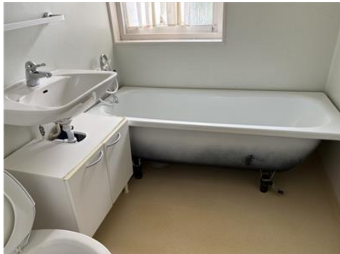
Äldre badrum, fönsterparti har lokala fuktskador.
